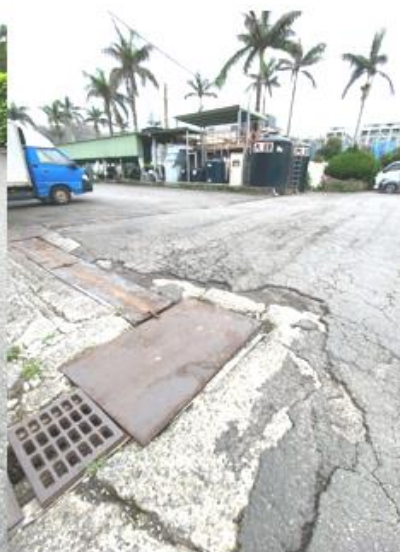
圖六、水溝蓋周邊不平整
