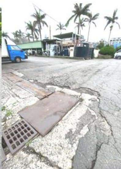
圖六、水溝蓋周邊不平整
