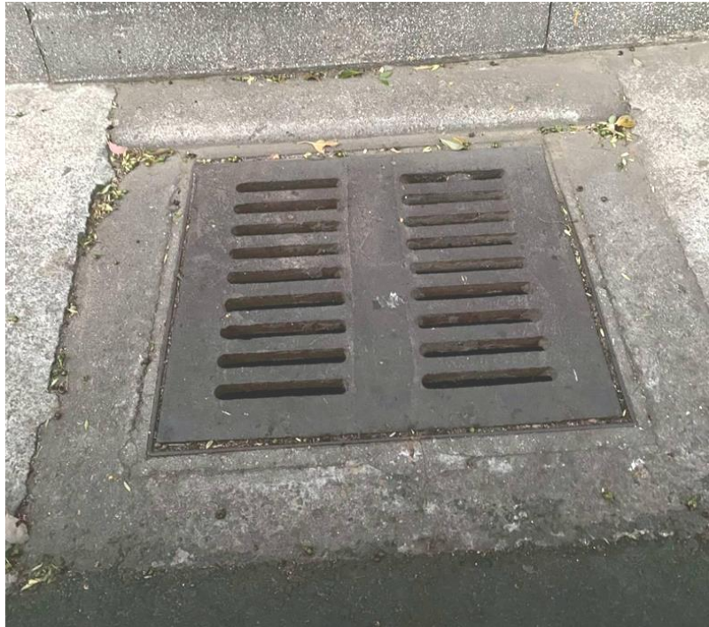
圖二、溝蓋與路面銜接處存有明顯高低落差
