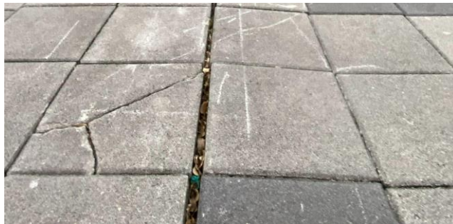
圖三、地磚破裂
