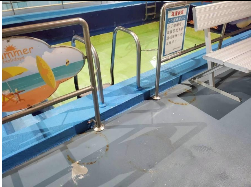
圖三、鐵製欄杆與其他部分出現腐蝕痕跡
