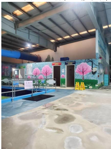
圖一、天花板漏水
