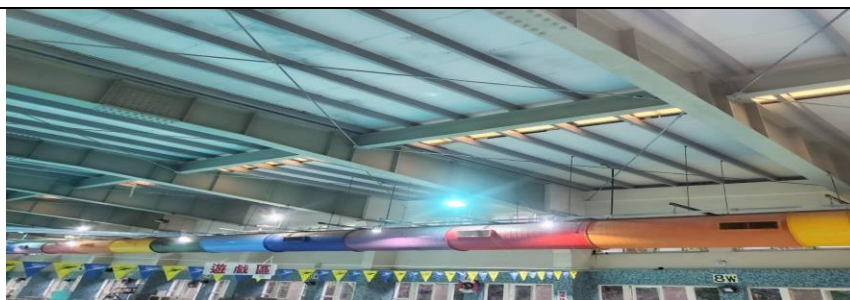
圖七、通風設備老舊
