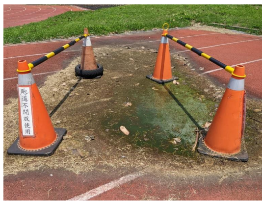
操場跑道積水下陷，無法使用。
