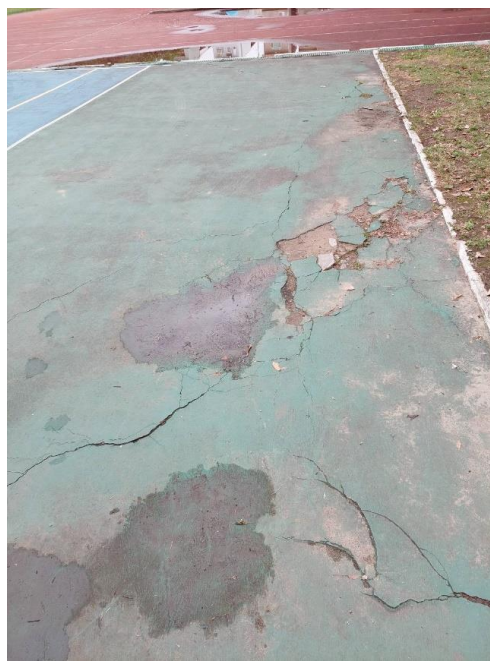
鋪面膠破損，砂土流失，凹凸不平，學生易受傷。
